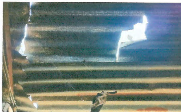
Foto 2: DETERIOROS DE LÁMINAS
