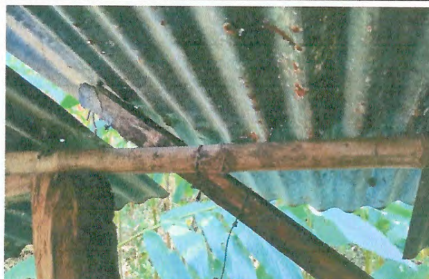
Foto 4: VIGAS EN MAL ESTADO
